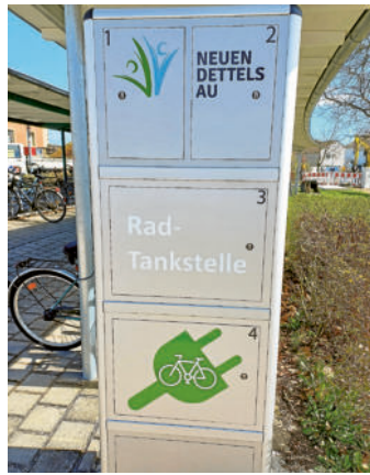
Ladeschrank am Bahnhof
