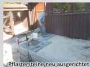
Pflastersteine neu ausgerichtet
